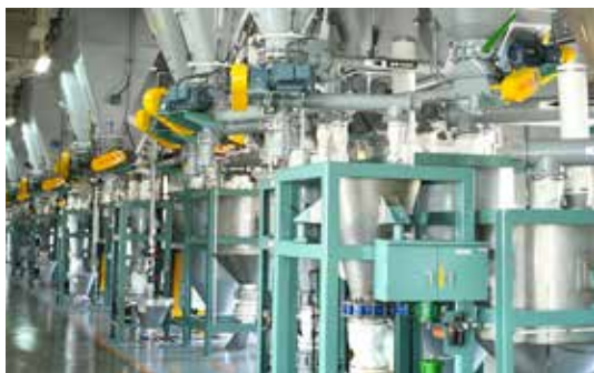
原料計量 Dosing equipment
